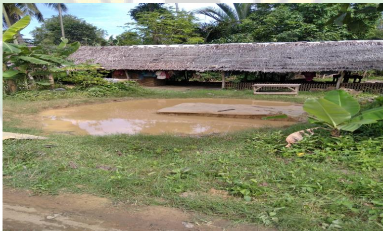
Gambar 4. Keadaan Tempat Pengadukan Material yang Tergenang Air
