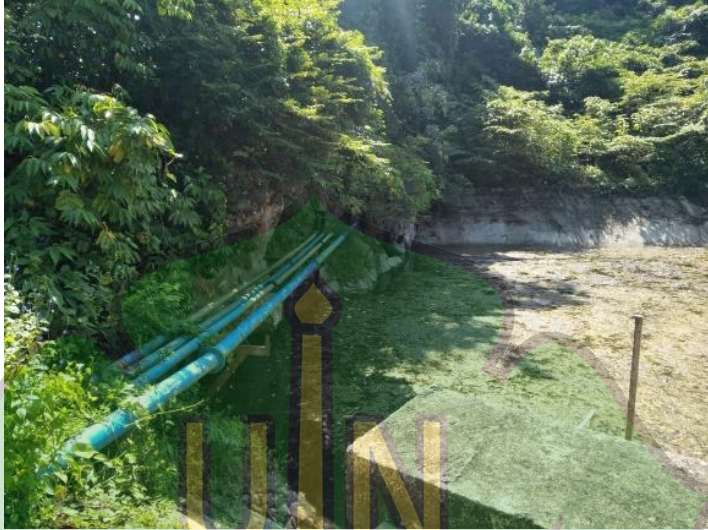
Gambar 4. 3 Pipa Air dari Sumber Mata Air
