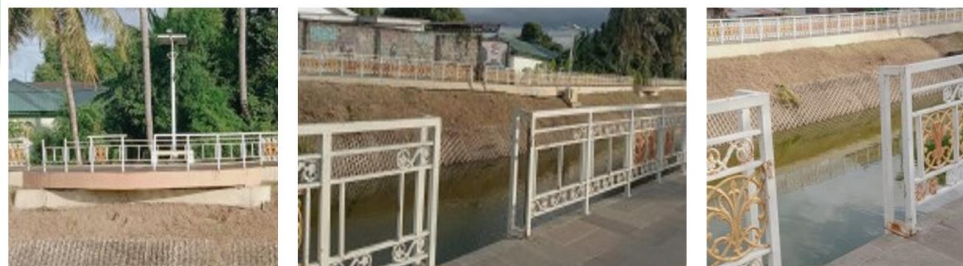
Gambar 4. 11 Kondisi Aktual Pagar Pembatas Sumber: Dokumentasi Pribadi 2022
