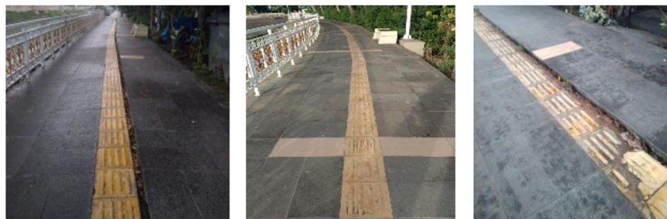
Gambar 4. 3 Kondisi Kerusakan Jalur Pedestrian Sumber: Dokumentasi Pribadi 2022
