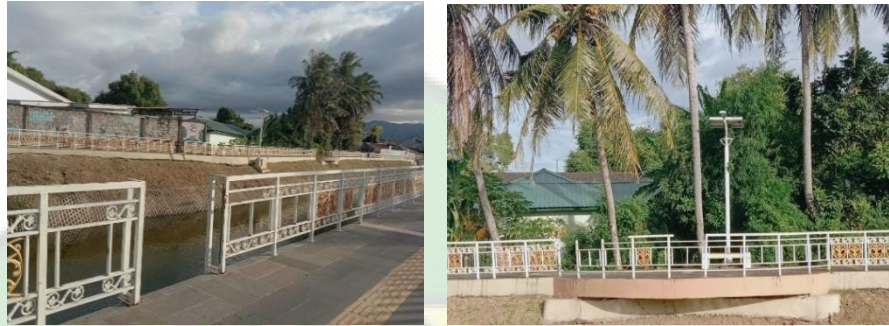
Gambar 4. 23 Kondisi Aktual Pagar Pembatas
