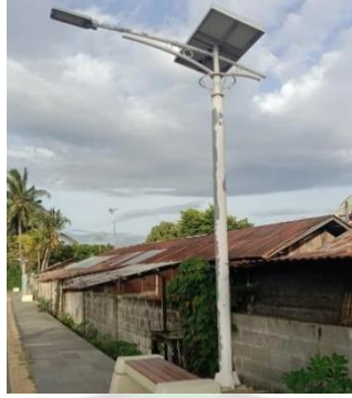
Gambar 4. 5 Lampu Penerangan Sumber: Dokumentasi Pribadi 2022
