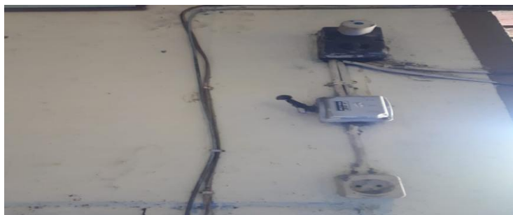
Gambar 14 . peruntukan kabel tidak sesuai standar
