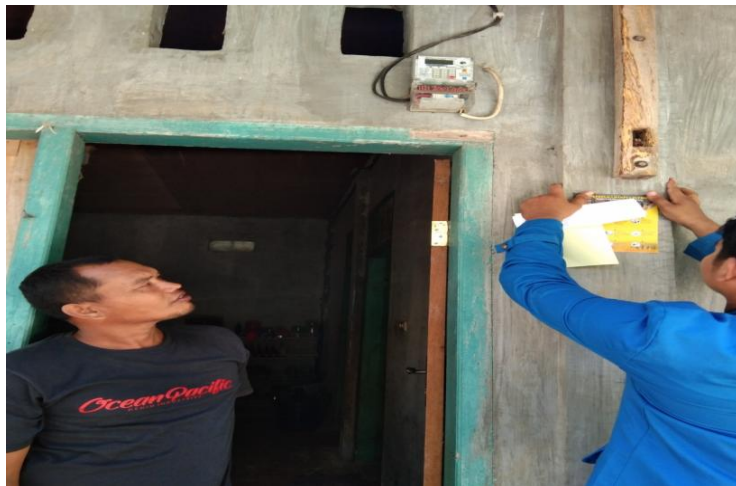
Gambar 15. Penggunaan instalasi perumahan tanpa grounding
