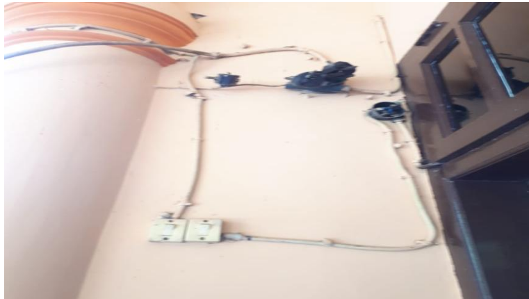
Gambar 11. Penggunaan listrik tanpa sekering
