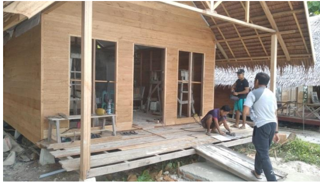
Sumber: Foto Pribadi (Pembangunan Couttage/Penginapan VIP BUMDes Karya Mandiri Desa Pulau Baguk)
