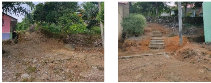
Gambar 4.6 Kondisi Tanah Eksisting (Sumber: Dokumentasi Pribadi)
