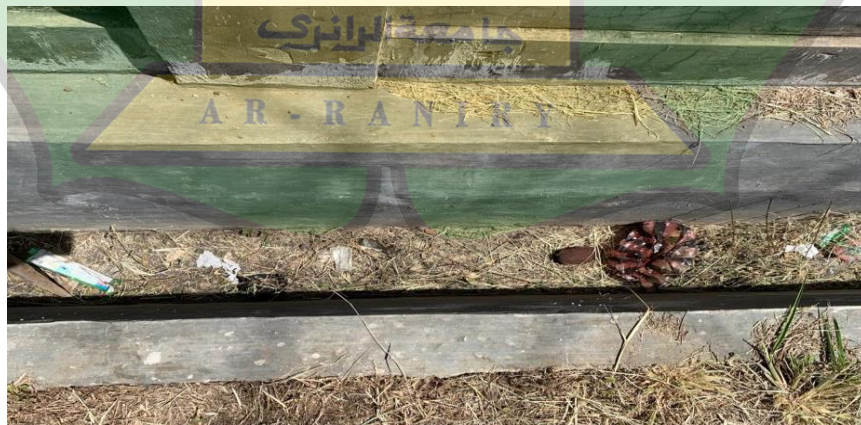
Gambar 4.1 Kondisi eksisting saluran drainase (Sumber: Pengamatan lapangan)
