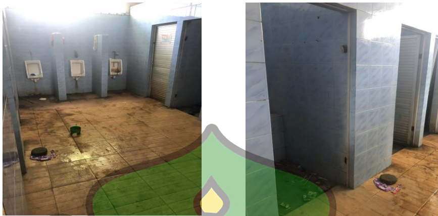
Gambar 2.1 Kondisi Toilet Di terminal Batoh yang berada dibelakang loket travel
