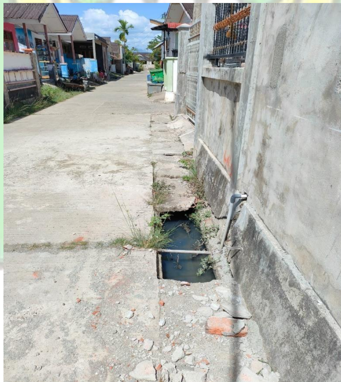
Gambar 4.1 Kerusakan tutup saluran
