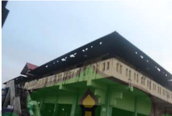
Atap bangunan berlobang dan tidak layak digunakan
