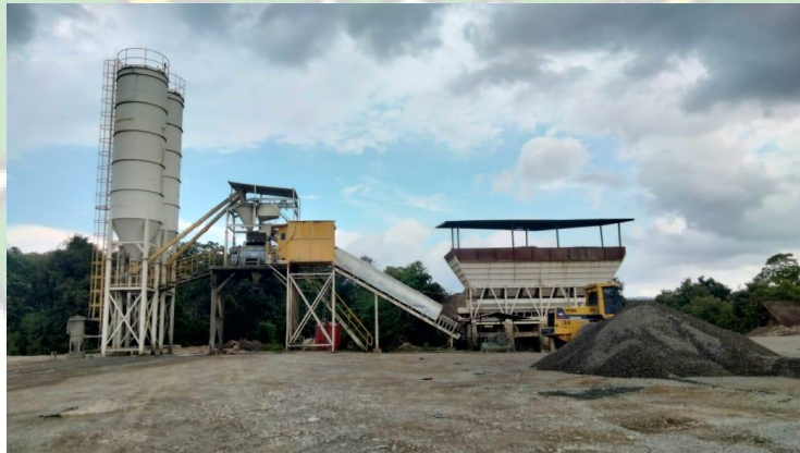
Gambar 2 Blaching Plant, Tempat Produksi Beton Ready Mix
