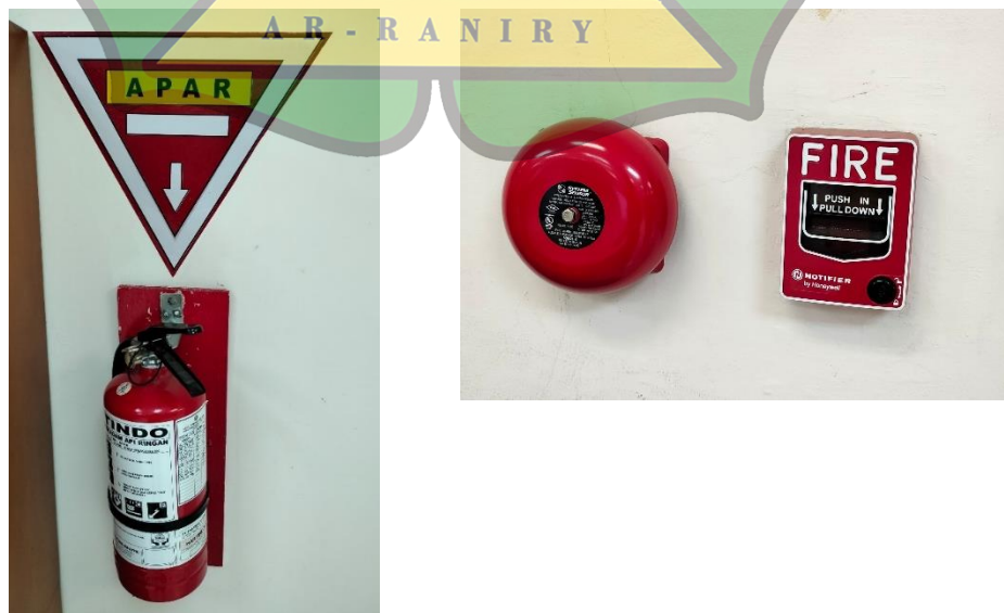
Gambar 4. 6 APAR dan Alarm Kebakaran
