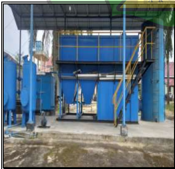
Instalasi Pengolahan Air Limbah (IPAL) RSUD Aceh Singkil
