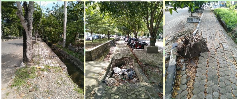
Gambar 1.5 Beberapa Area jalur Pejalan kaki yang rusak
