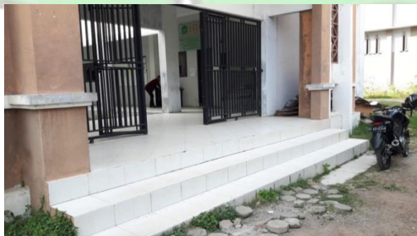
Gambar 4.19 Tidak adanya ramp pada pintu masuk
